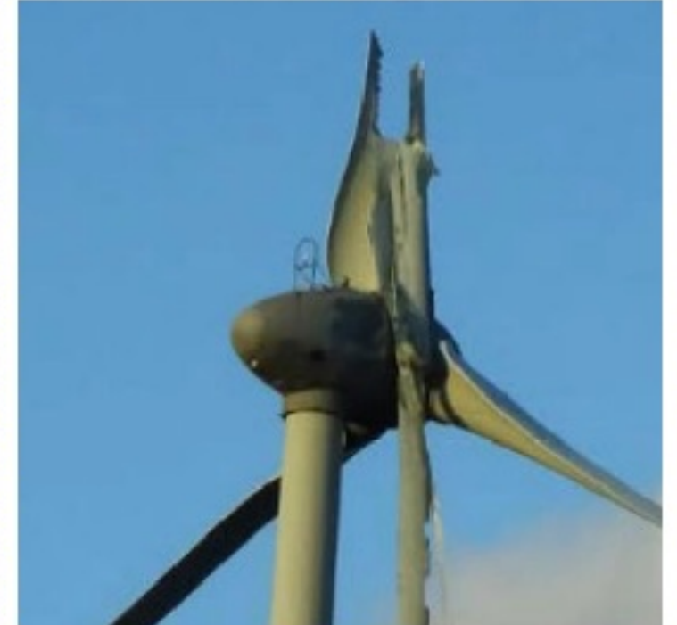
震度7を記録した志賀町に設置されている2000kW級風車のブレード破損の状況。
